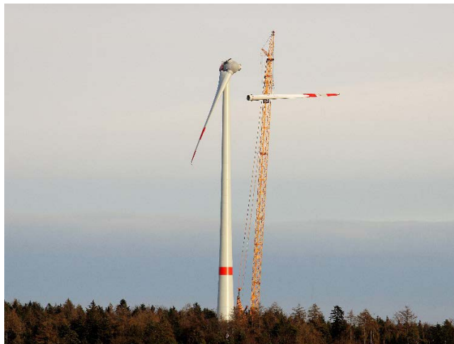
Abbildung 14: Anlagenerichtung im Windpark Brenntenberg, Landkreis Regensburg (Bayern)
